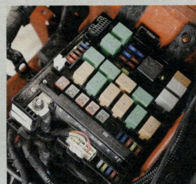
Lekko przykurzone: w puszcze z bezpiecznikami i przełącznikami widać drobne ślady brudu, na szczęście do środka nie dostała się wilgoć
